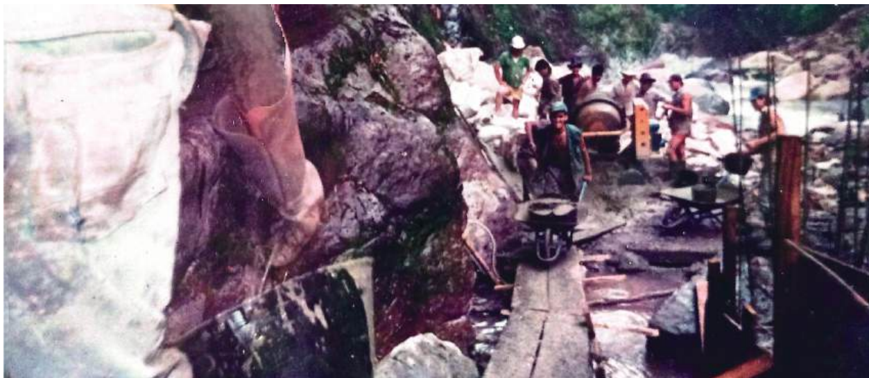
Fotografía 5 Jornada de trabajo en la construcción del acueducto de Villavicencio en la vereda Quebrada Honda con personal de las veredas Santa María Alta, Quebrada Honda, Lourdes y Santa Teresa. Sin fecha.
