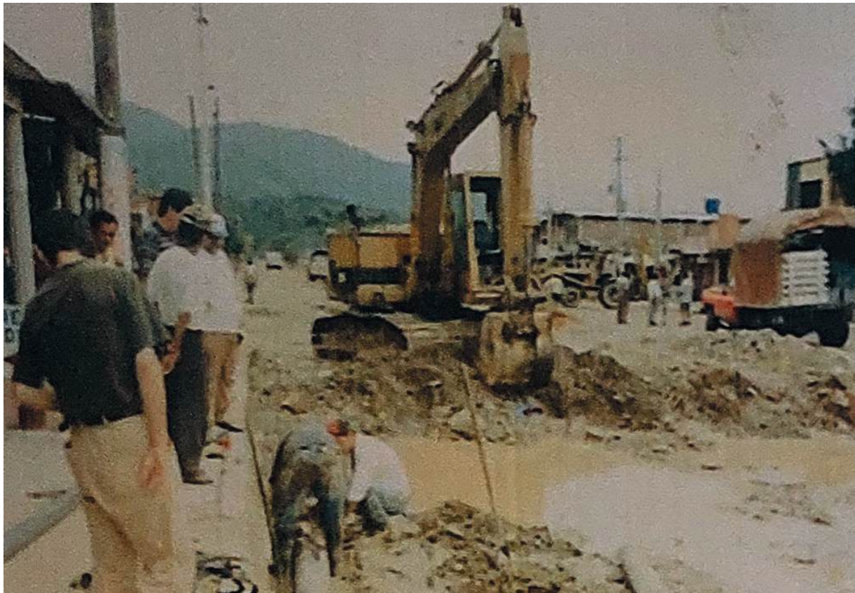
Fotografía 23 Instalación de tubería del acueducto comunitario de Ciudad Porfía en la década de los noventa. Sin fecha. Créditos: Museo Comunitario de Porfía
